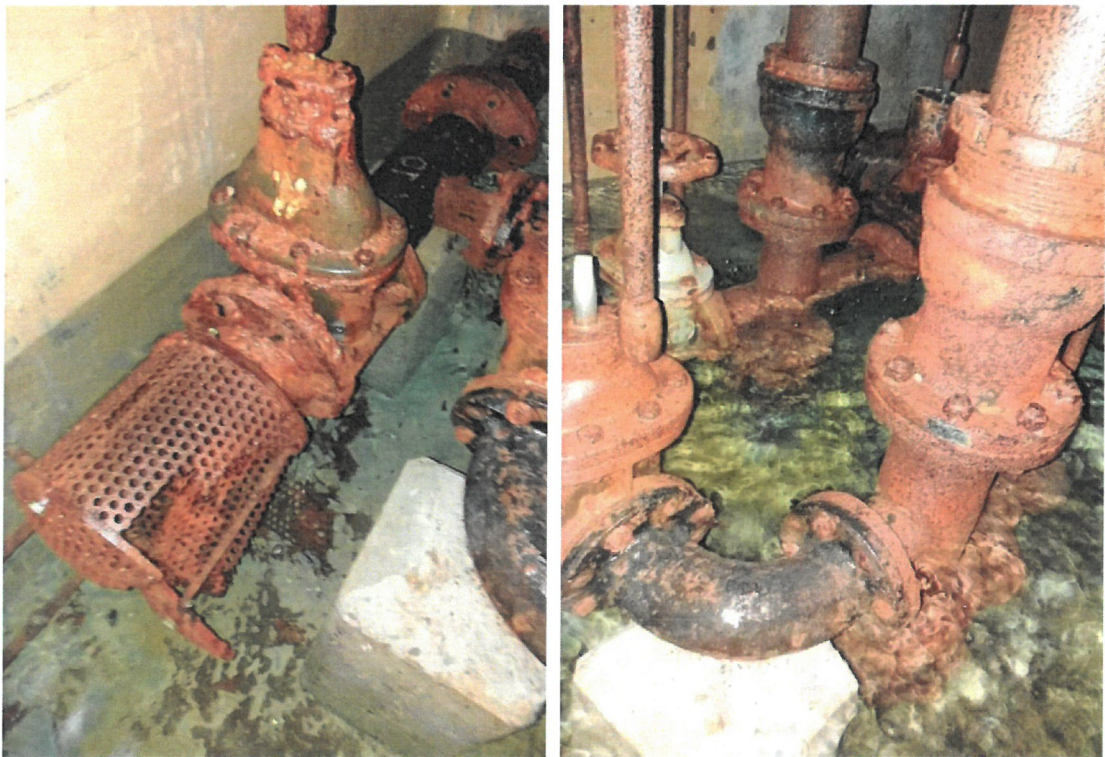
Vue des installations présentes au fond du réservoir de compensation.
